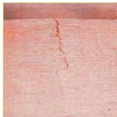
FALLA DE COMPRESIÓN
